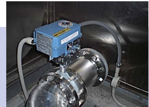
災害時に受水槽の水を有効利用できる
