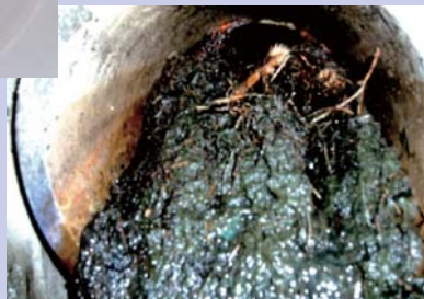
改修前（管内に木の根が進入）
