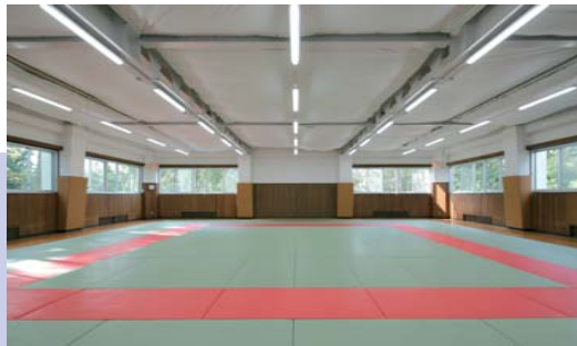
1階柔道場 LED照明採用 落下防止対策 老朽改善
