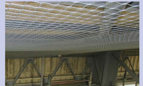
天井材落下防止ネット
